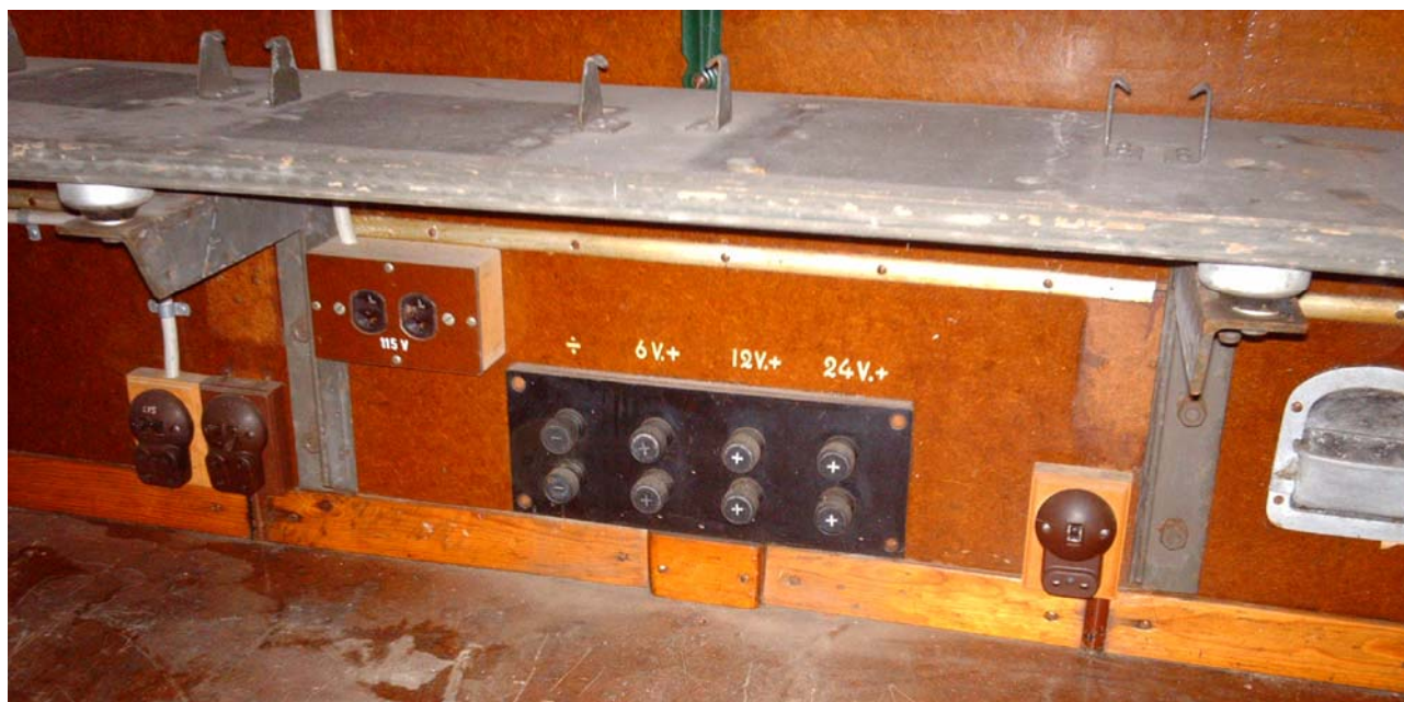
Strømpanel ved arbejdsbordet.
